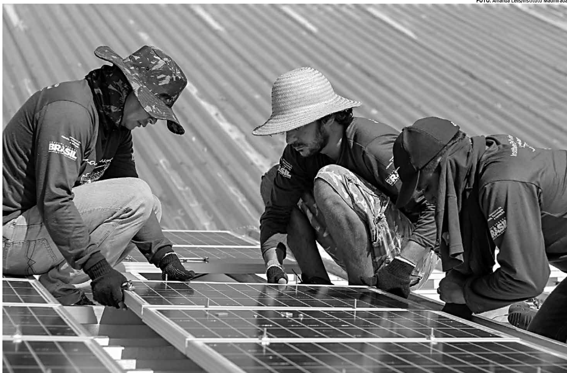
Pescadores instalam o equipamento que possui um sistema fotovoltaico que dispensa o uso de baterias e consiste em 60 painéis
